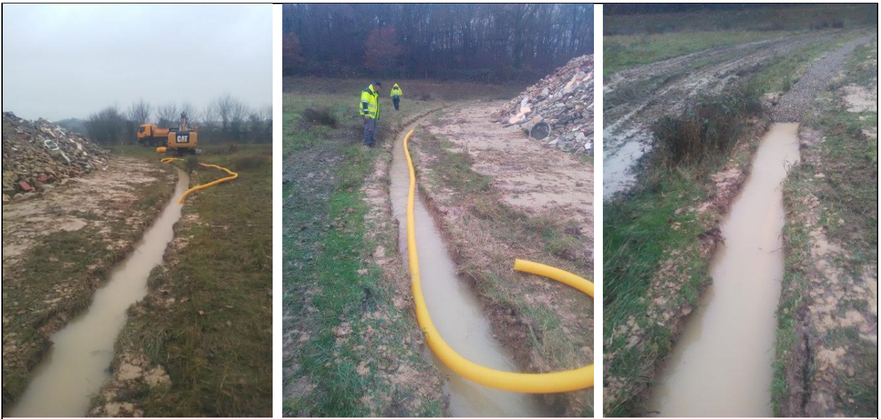
Ouvrage de drainage des eaux pluviales retenues dans le casier ISDI (déc. 2018)
